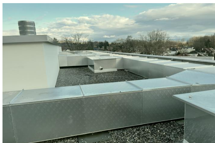
Lüftungsverteilung Dach Hauptgebäude
