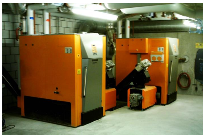
Pelletheizung 2 x 150 kW
