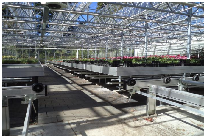
Innenansicht mit Untertischinstallationen
