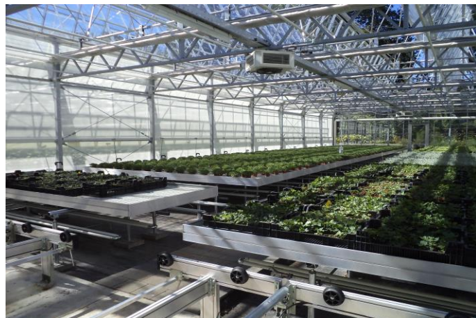
Innenansicht mit Deckeninstallationen
